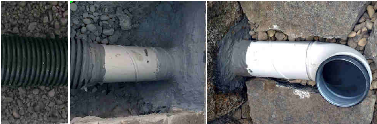
Figura 6 - Instalación de la capa de grava, el tubo perforado y el tubo pasamuros
