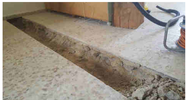
Figura 5 - Zanja para la instalación del tubo perforado y la capa de grava
