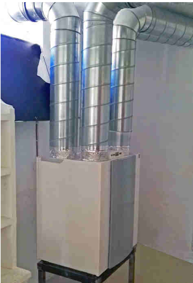
Figura 5 - Equipo de ventilación
