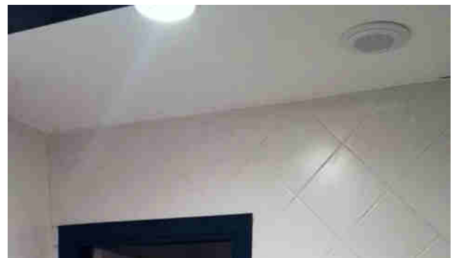
Figura 7 - Abertura de extracción de aire en un aseo
