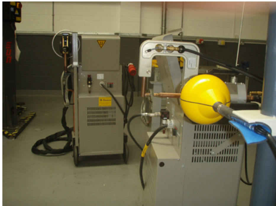
Figura 6.7. Mediciones alrededor del equipo soldador por puntos de un taller de reparación montado con una pistola «tipo C» y el brazo de 160 mm instalado. El soldador «tipo X» está al fondo
